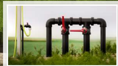
Aplicación del Netvite System® en un colector de distribución en un invernadero, que muestra el ahorro en piezas y montaje, así como la facilidad a la hora de realizar labores de mantenimiento. (Más información pg. 329)
